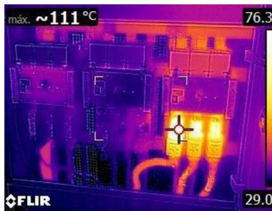
Figura 2: Representação visual dos fusíveis na câmera termográfica
